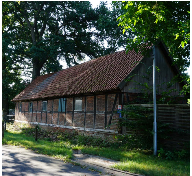
Abb. 92: Untergenutztes landwirtschaftliches Nebengebäude
